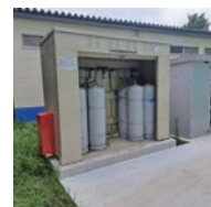
倉庫と並んでLPガスの 設置場所も確保
